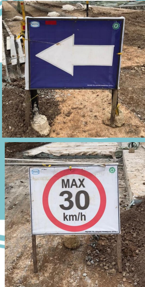
Gambar 4. 46 Rambu pada Akses Jalan Kerja dan Area Konstruksi
