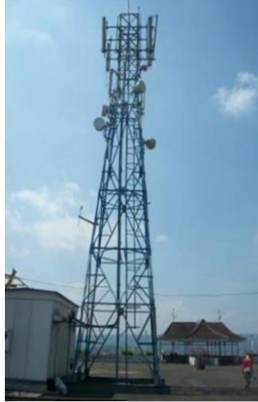
Gambar 2. 5 Tower Diatas Atap Sebuah Gedung
