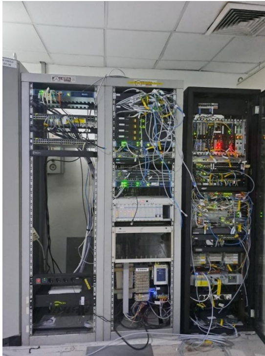
Gambar L-4. 3 Perangkat Switch HSR di Data Center
