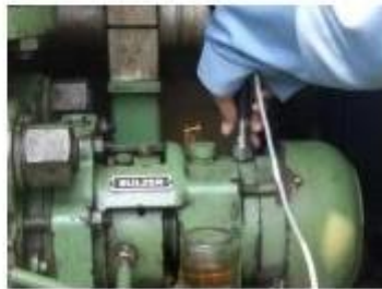
Gambar 8. Pengambilan data vibrasi arah vertical pada Fuel Oil Skid Pump
