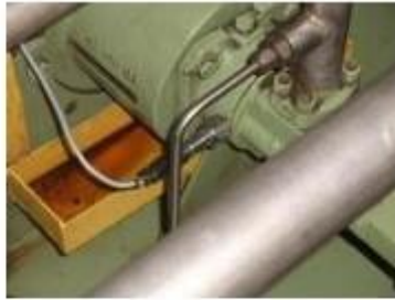
Gambar 7. Pengambilan data vibrasi arah horizontal pada Power Oil Pump GT 11
