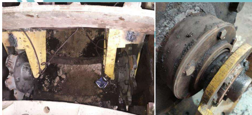
Gambar 1. 1 Kerusakan Pada Intermediate Sprocket
