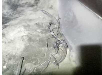
Gambar 1 Kerusakan pada packing gland
