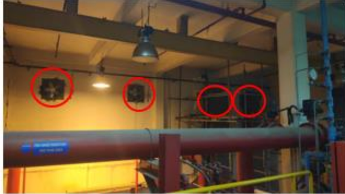
Gambar Exhaust fan Gedung firefighting
