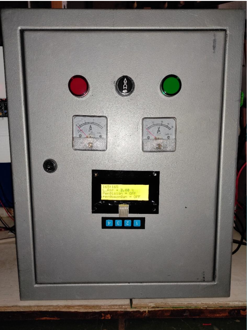
Tampak Luar Panel
