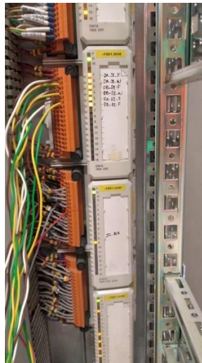
Gambar 5 Module Hardware I/O Tersambung Sensor serta Output
