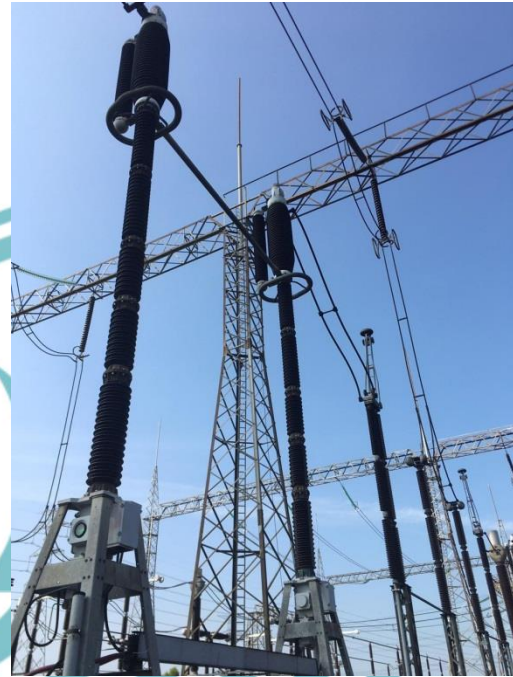
Kebocoran Gas SF 6 Pada PMT 500 KV GITET Cibatu Selesai
