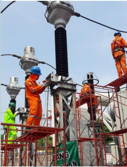
Pemeliharaan serta pengujian CT & LA 150 KV
