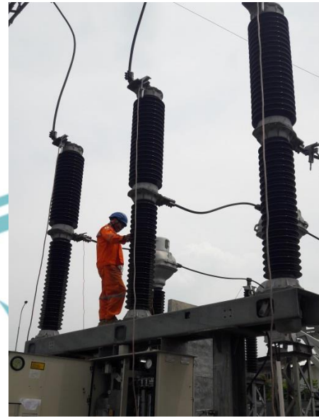
Pengujian Keserempakan pada PMT 150 KV
