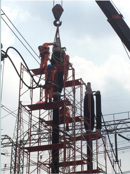
Pek. Kebocoran Gas SF 6 Pada PMT 500 KV GITET Cibatu
