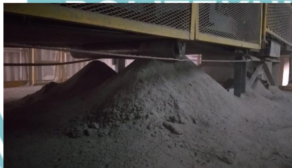
Gambar 1.2 Spillage pada Nr.532-BC3
