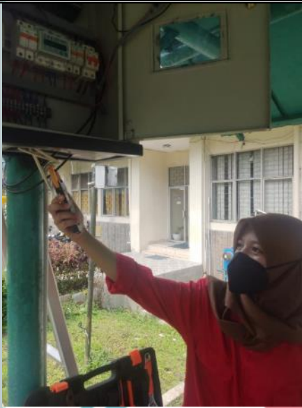
Proses pengambilan data ukur menggunakan tang ampere
