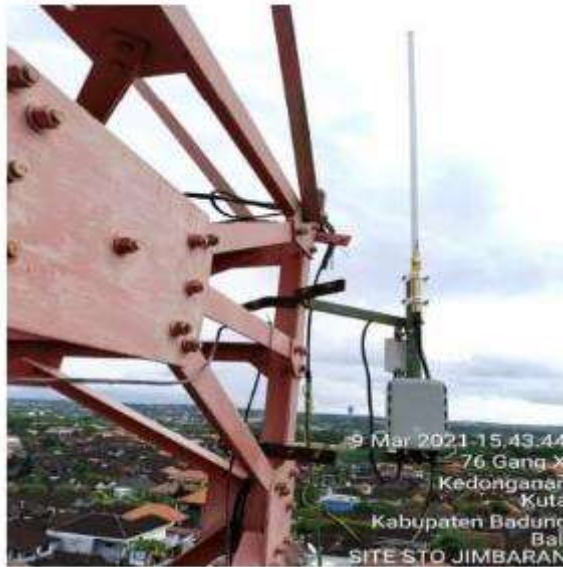
Area di sekitar antenna untuk memastikan tidak ada penghalang
