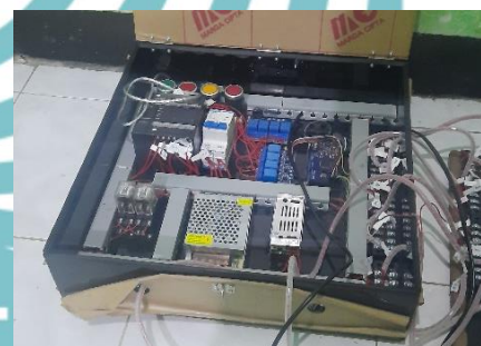
Gambar L.3 Tampak Dalam Panel
