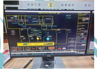
Data temperatur oil bering turbin dan generator
