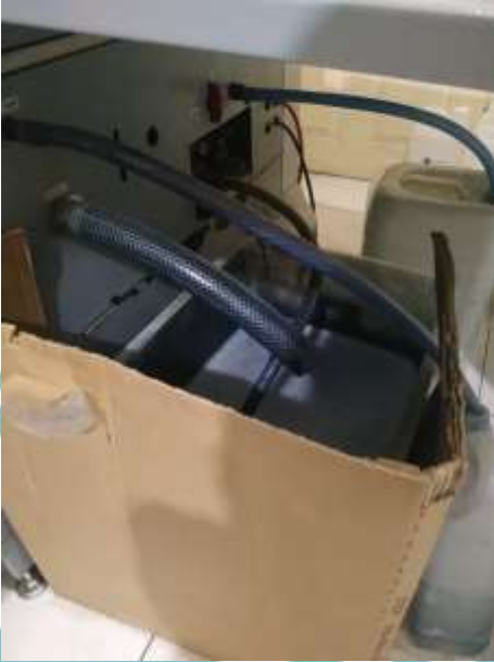
Gambar Lampiran 2.6 Selang Air di Mesin Develop
