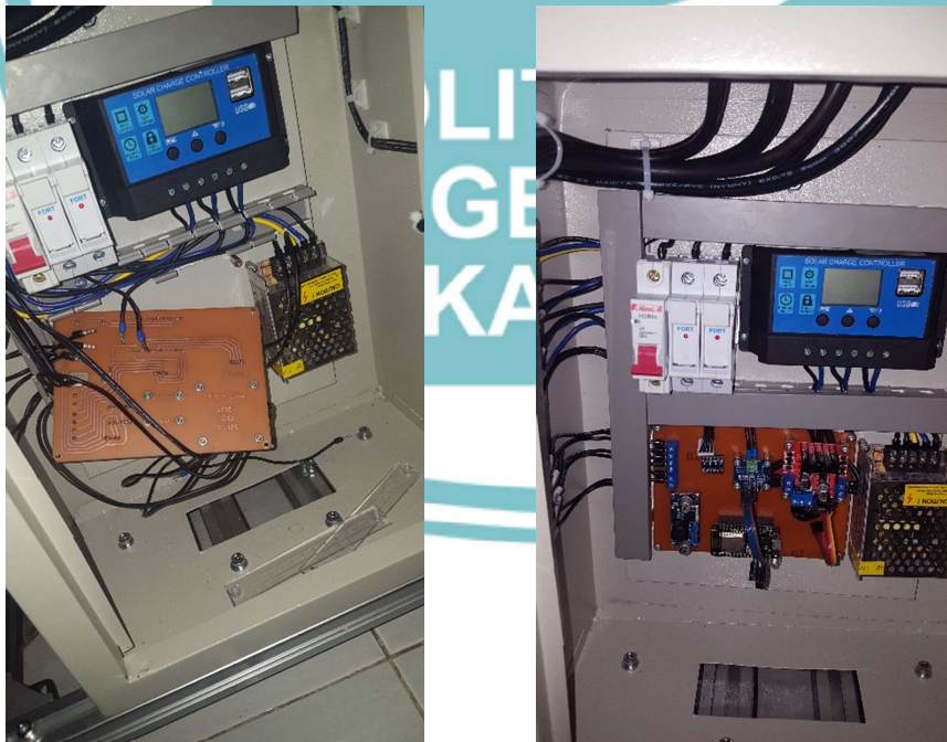
Gambar dokumentasi komponen dalam panel box sebelum dan sesudah wiring
