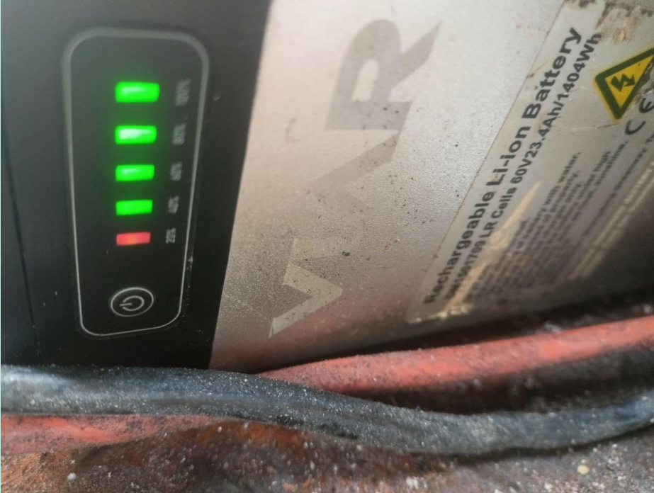
Dokumentasi performa baterai 100%
