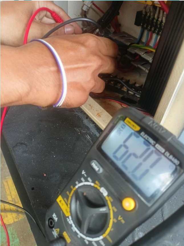
Dokumentasi performa baterai 60%
