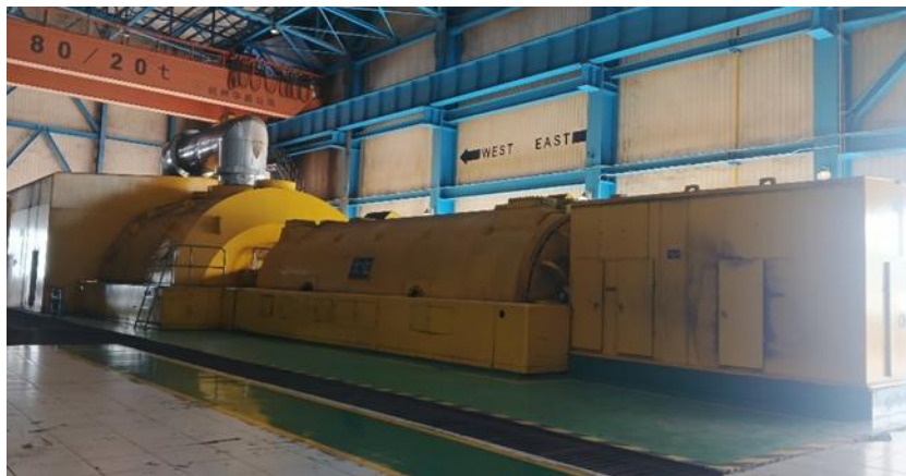
Gambar 2.1. Generator Sinkron (Sumber: Dokumentasi Pribadi)
