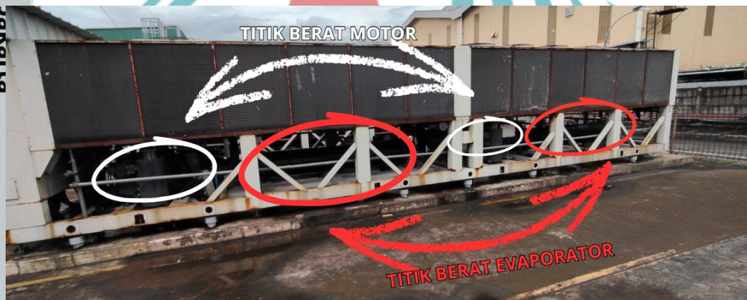
Gambar 1.1 Ilustrasi Rangka yang menahan beban dari mesin chiller
