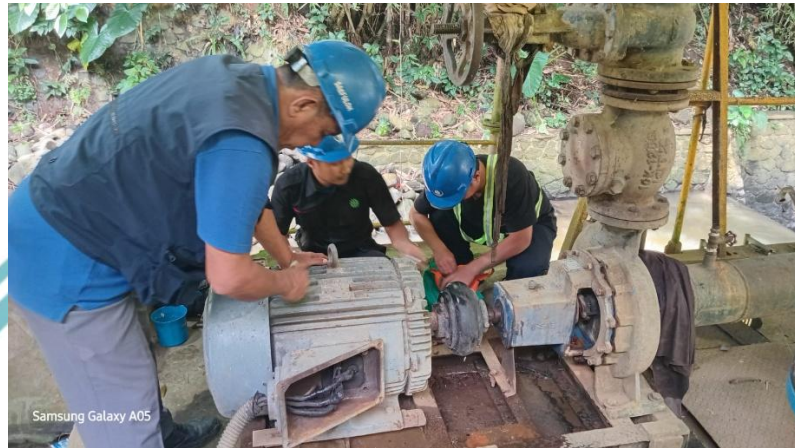
Gambar 1. 1 Unit pompa sentrifugal di lokasi IPA Unitex Tajur (sumber: Dokumentasi pribadi)
