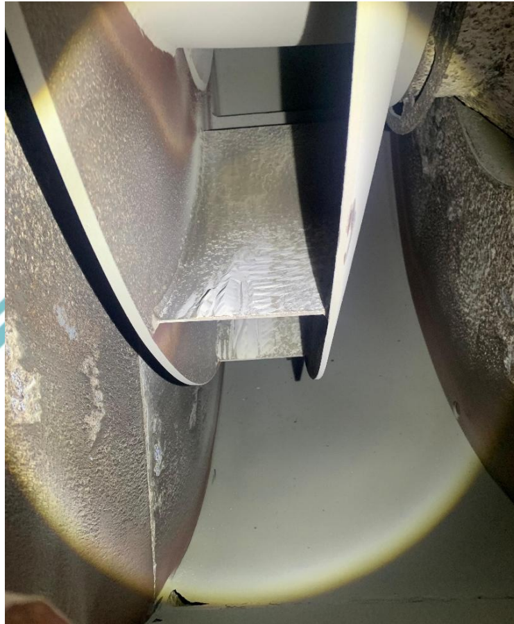
Gambar 1.1 Centrifugal Fan mengalami korosi dan keausan (Source : Dokumentasi Pribadi)
