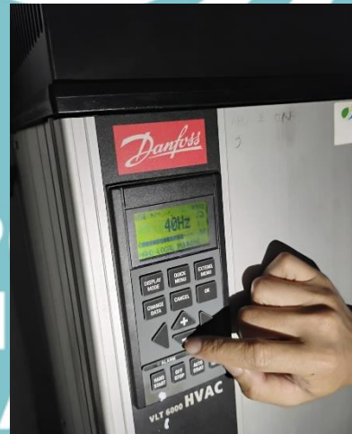
Pengaturan kecepatan blower AHU
