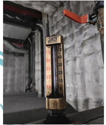
Suhu AHU sebelum masuk ke ruangan
