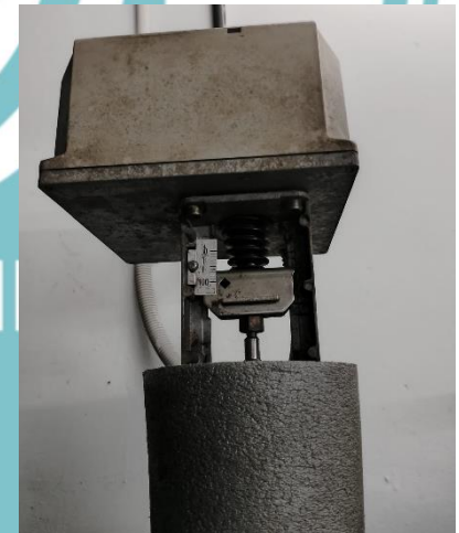
Bukaan udara di AHU
