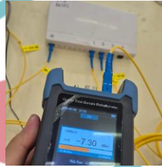
Pengukuran daya keluaran OTB Akses port 1 menuju ONT Lantai 3.
