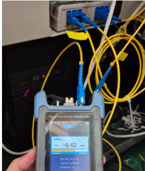
Pengukuran daya keluaran OTB Utama port 1 menuju OTB Akses.
