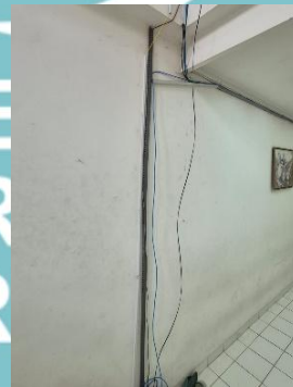
Jalur riser serat optik menuju ONT Lantai 2 dan Lantai 1.
