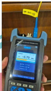
Pengukuran daya optik pada titik akhir jalur ONT Lantai 1.
