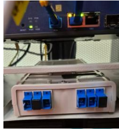
OLT GPON dan OTB Utama pada rak server Smartlab Lantai 3.
