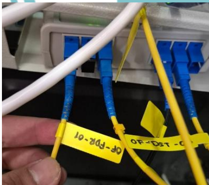
Pelabelan port dan kode serat pada jaringan distribusi.
