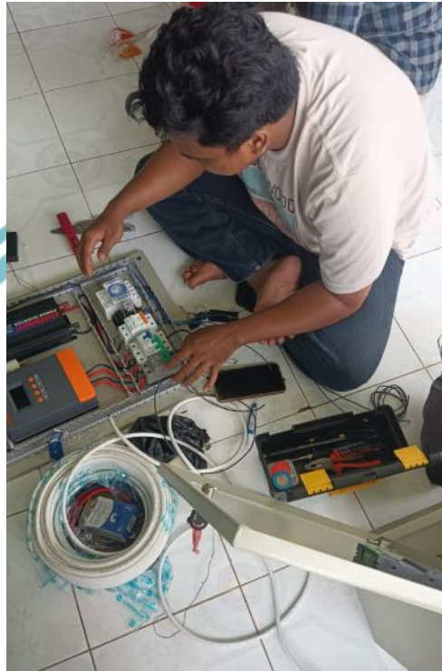
Lampiran 1. Dokumentasi Wiring Panel
