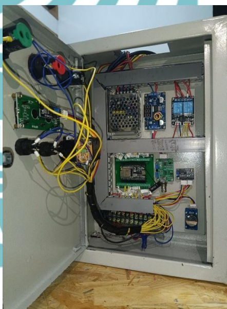
Tampak Papan Kontrol
