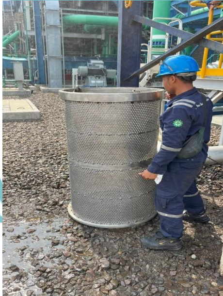
Gambar 6 : Drain Strainer SWBP yang kotor
