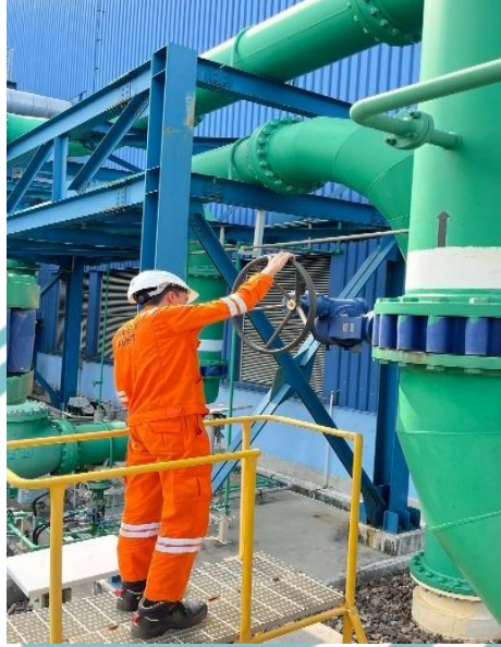
Gambar 5 : Blokir katup strainer SWBP yang kotor
