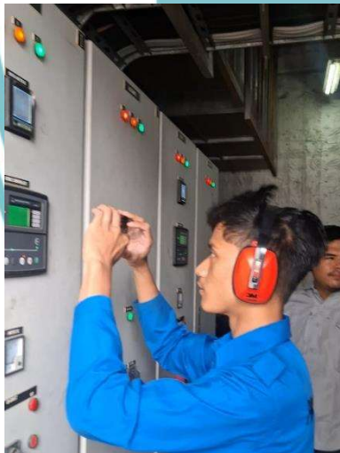
Monitoring arus listrik pada genset
