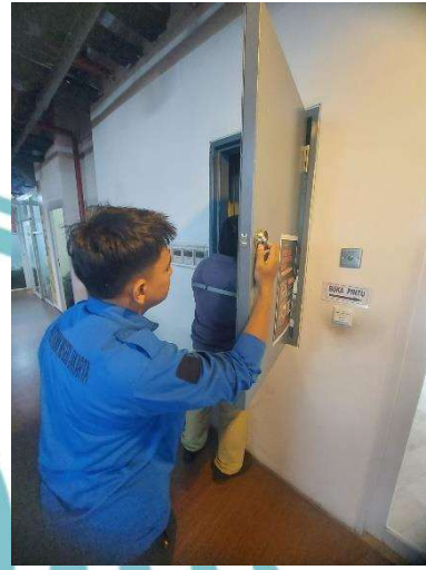
Pengecekan komponen proteksi AC central untuk lantai 4
