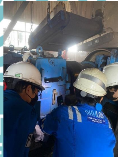
Gambar 27 Pengecekan parameter oli Hidrolik Pump Diverter Gate BC 4 to BC 5 A/B
