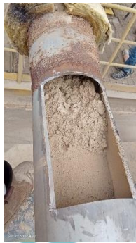
Gambar 1 Blocking di Pipa Conveying
