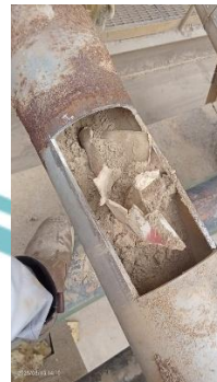
Gambar 2 Benda Asing di Pipa Conveying
