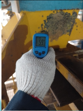
Gambar 5.3 Cek Suhu AV Pump Unit 2
