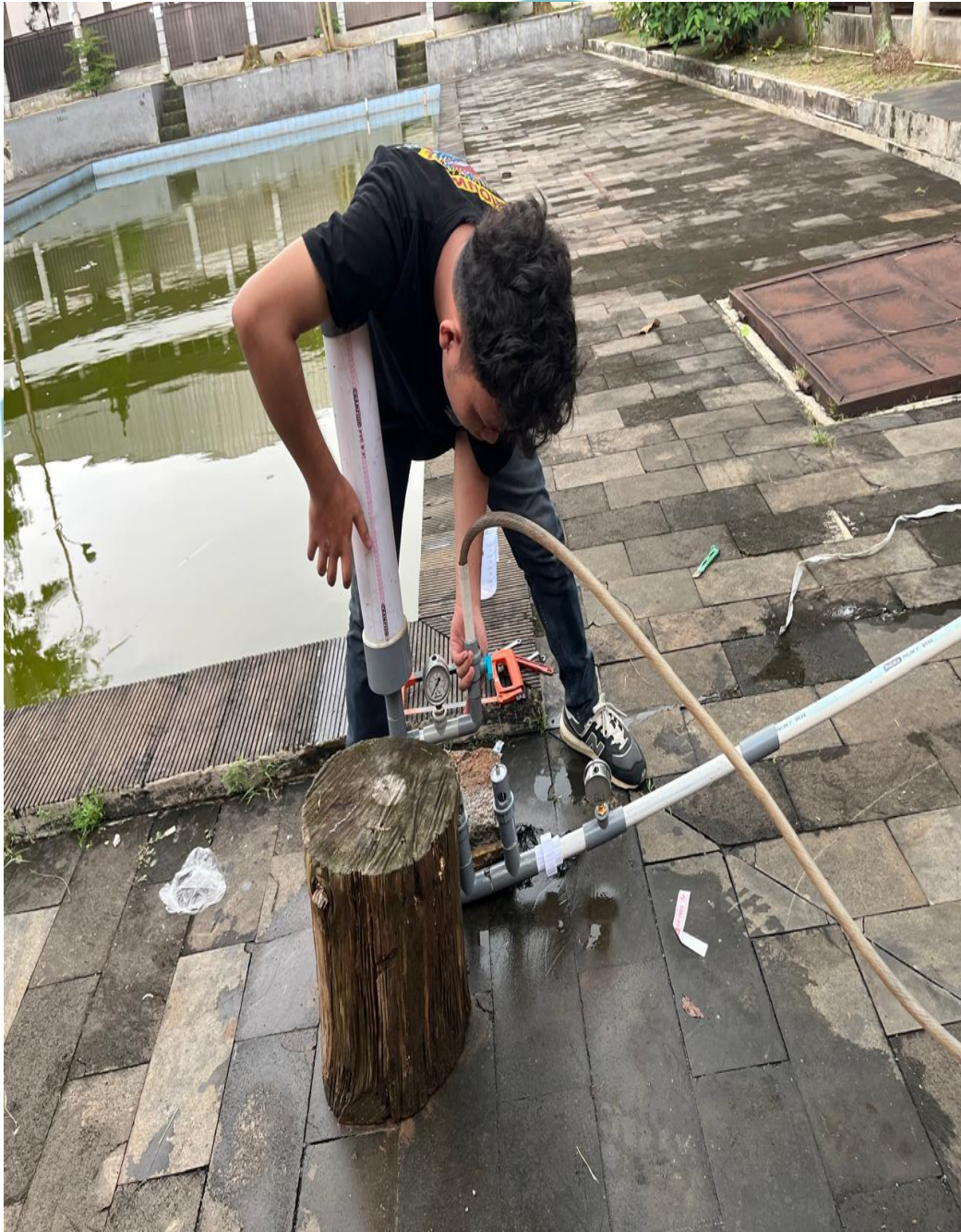
Lampiran 5. Dokumentasi Pemeriksaan sambungan dari kebocoran
