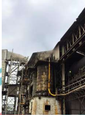
Gambar 1.2 Kondisi dusty pada bag filter (482-BF1)
