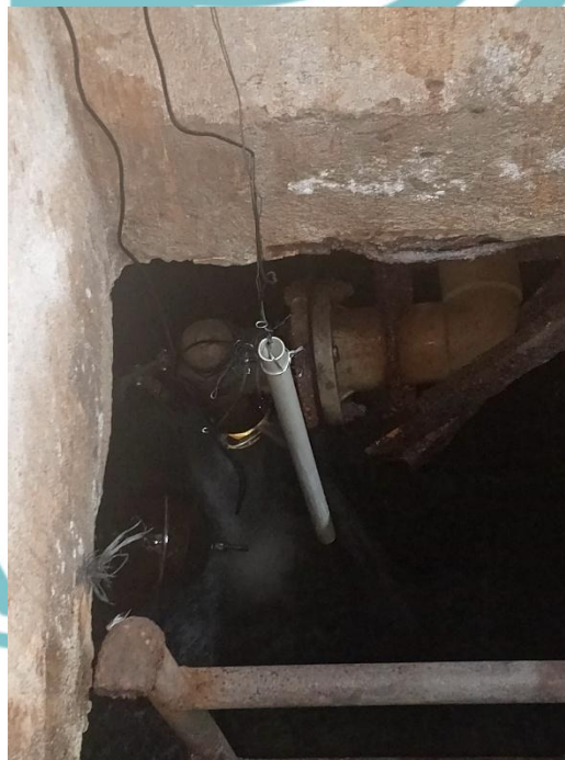
Lampiran 1. 4 Pemasangan Sensor Aliran Air dan Sensor Jarak
