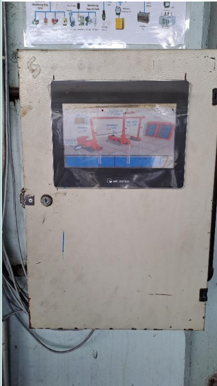
Tampak Luar Panel
