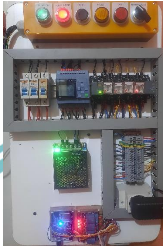
Tampak Papan Kontrol
