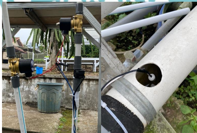
Solenoid valve dan flowsensor pada sistem perpipaan Larutan. Serta probe sensor TDS pada sistem DFT Hidroponik
