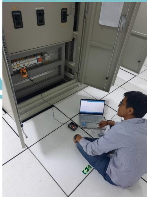
Pengambilan data pada ruang MCB
