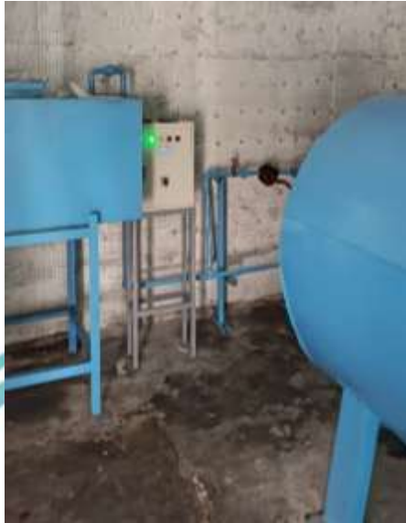
Dokumentasi posisi penempatan panel kontrol
