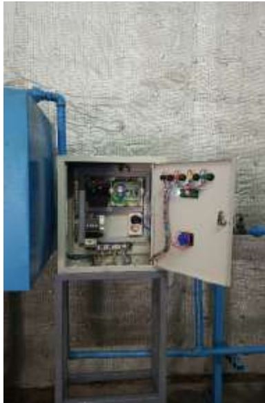
Dokumentasi running test sistem otomatisasi berbasis PLC dan IoT
