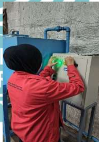
Dokumentasi pelebelan indikator pilot lamp pada panel
