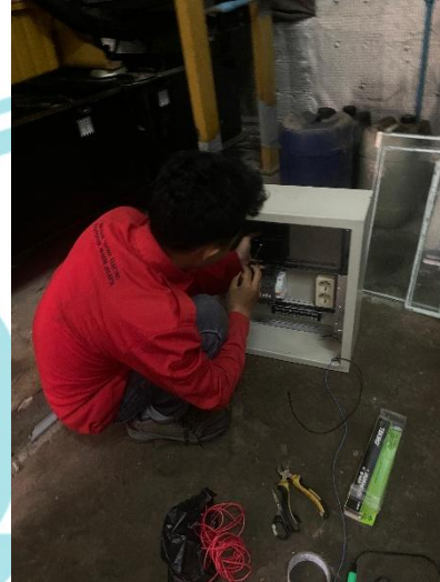
Proses pemasangan komponen kontrol
