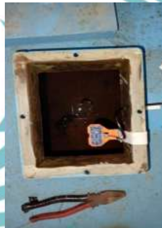
Gambar 3. 17 Pemasangan Sensor Ultrasonik
