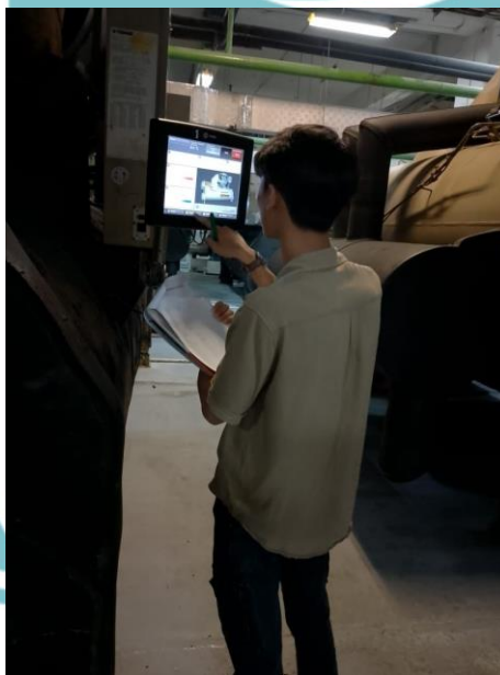
Lampiran 2 Loogsheet Chiller
