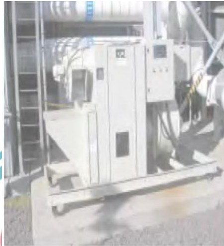
Gambar 4.3 Contoh Lokasi Pemasangan Dehumidifier di Luar Ruang HRSG
