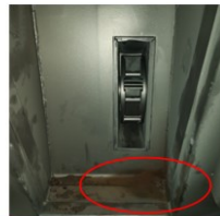
Ada korosi dalam cabinet
