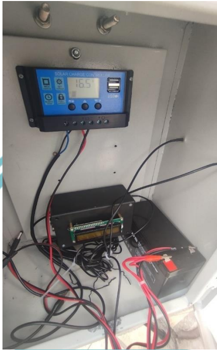
L8 Penempatan alat pada box panel
