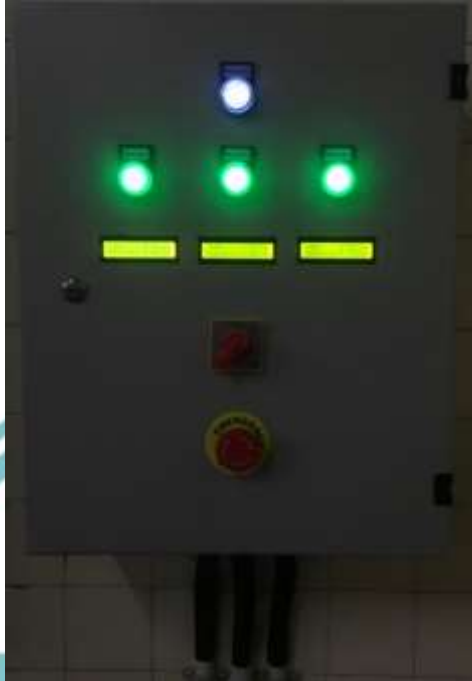
Lampiran 1. 9 Tampak Depan Pintu Panel
