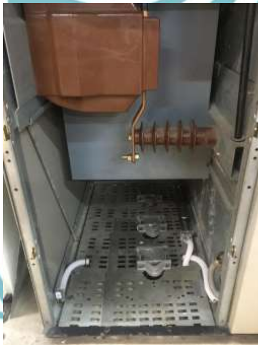
Lampiran 1. 10 Tampak Ruang Terminasi Kubikel
