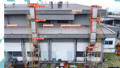
Gambar 4. 28 Deteksi Kerusakan Gedung menggunakan YOLOv5s
