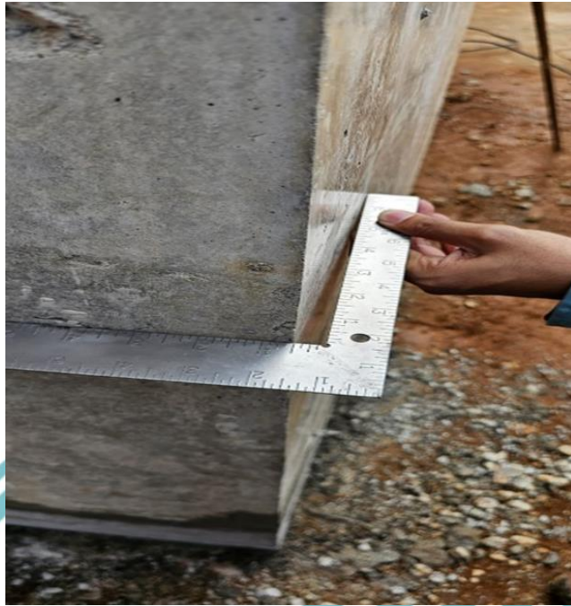
Gambar 3. 106 Kolom tidak Siku pada Lt. Basement
