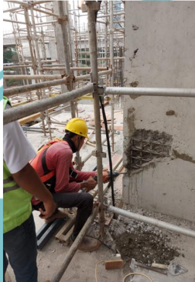
Gambar 3. 114 Perbaikan Major Honeycomb kolom lt2 Sumber : Dokumen Proyek
