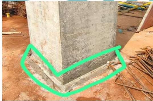
Gambar 3. 112 Minor Honeycomb pada dinding lt1
