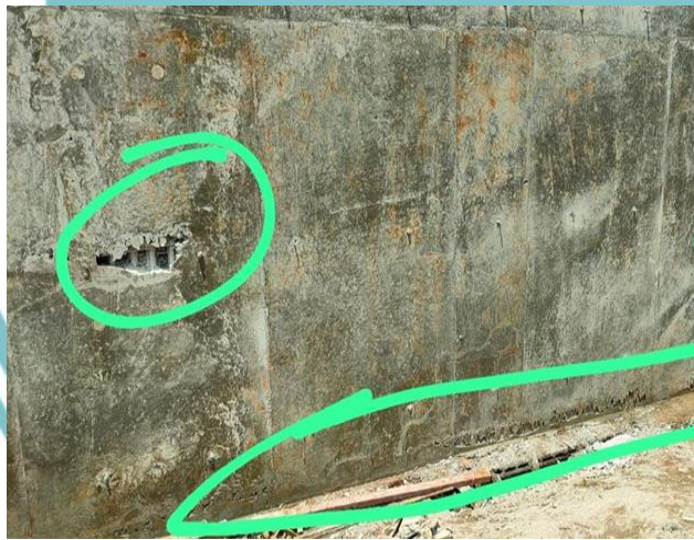
Gambar 3. 103 Major Honeycomb pada Dinding Lt. Basement
