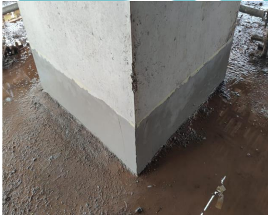
Gambar 3. 113 Hasil Perbaikan Minor Honeycomb pada Kolom lt1
