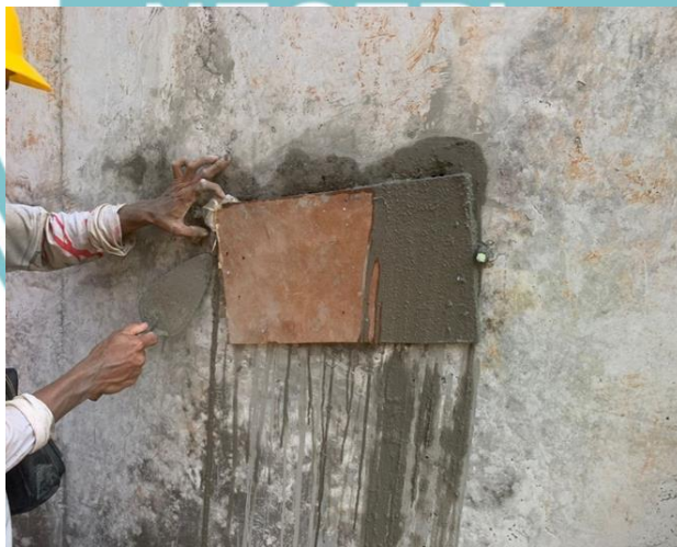
Gambar 3. 104 Pekerjaan Perbaikan Major Honeycomb
