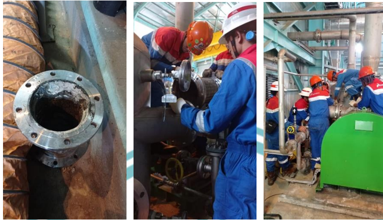
27. Penggantian fleksibel join pada LRVP unit 5, karena terjadi kebocoran.
