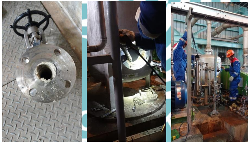
28. Pembersihan silika serta scaling yang ada pada jalur kondensat, valve dan separator tank NCG pada LRVP unit 5.
