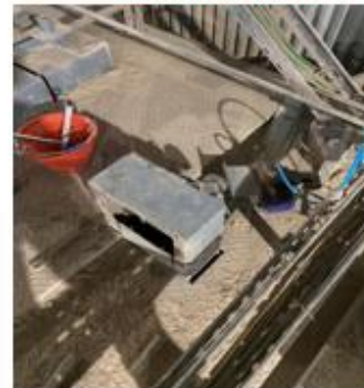
Cover actuator belum diganti yang baru
